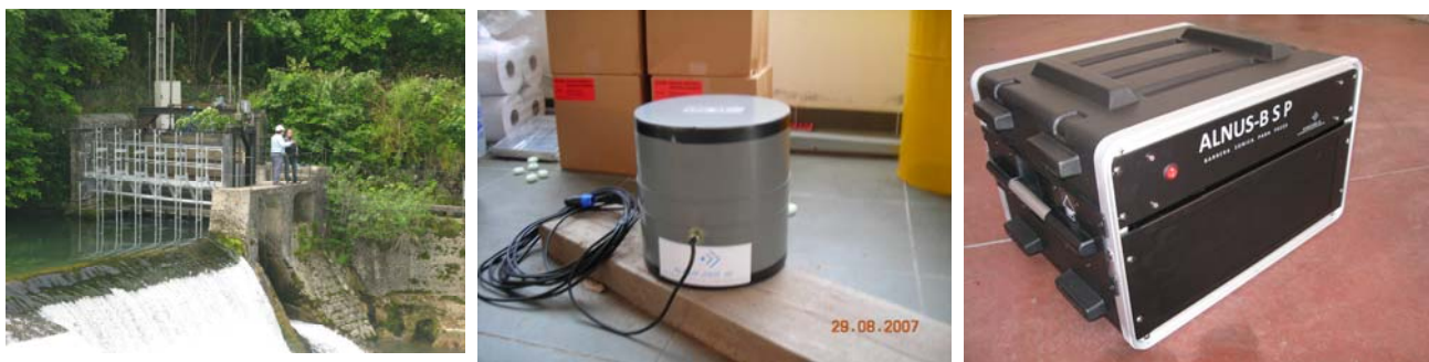
Barrera sónica instalada en el AH de Caño en el río Sella (Asturias)
