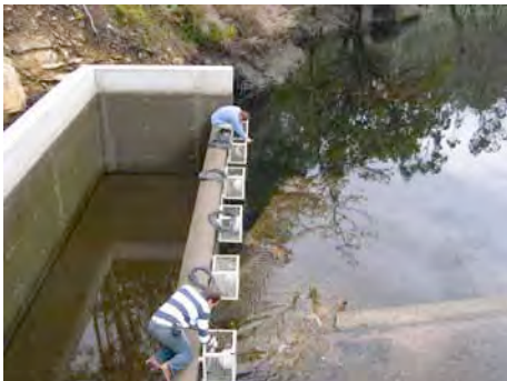
Instalación de altavoces en la obra de toma del AH del Umia (Pontevedra) con equipos BSP.
