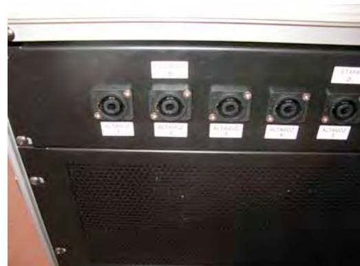
Conexiones de los transductores al equipo
