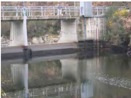
Obra de toma del AH del Barbantiño (Ourense) con equipos BSP.
