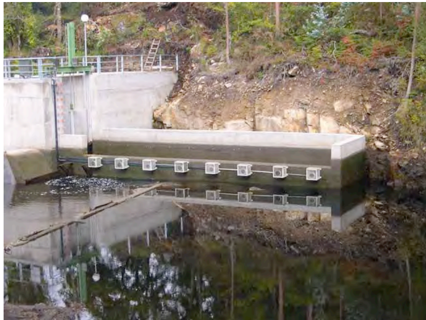
ALNUS-BSP en la obra de toma del AH Umia (Pontevedra)
